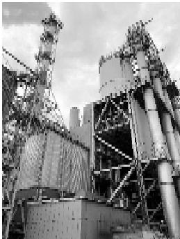
【製紙工場のボイラ】
