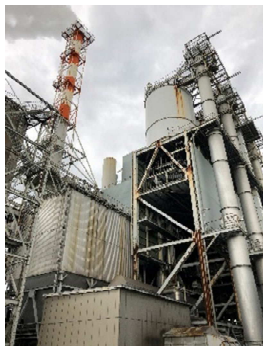
【製紙工場のボイラ】
